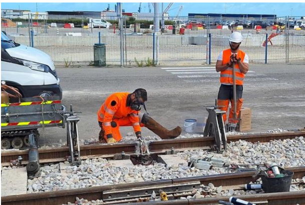
La pose d'une aiguille sur les rails au niveau de l'ancien passage à niveaux de la gare maritime de Cherbourg (Source : Radio-France)
